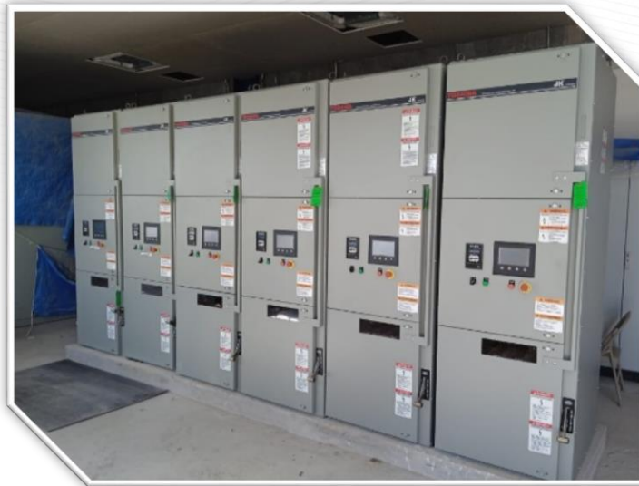
Centro de control y monitoreo CCM
